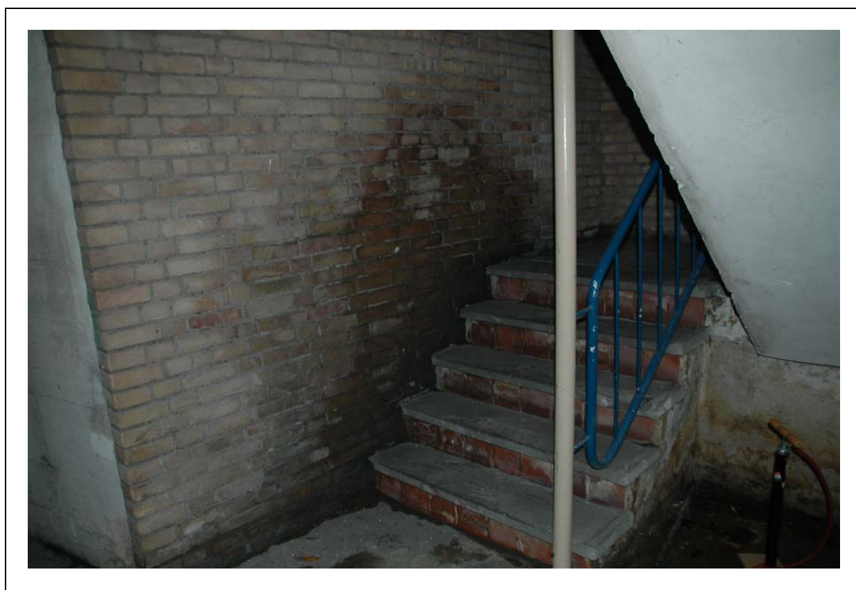
foto 4: De lekkage in de kelder.
