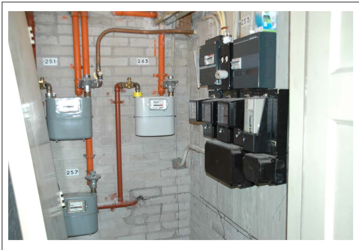
foto 13: Een van de meterkasten in de kelder.
