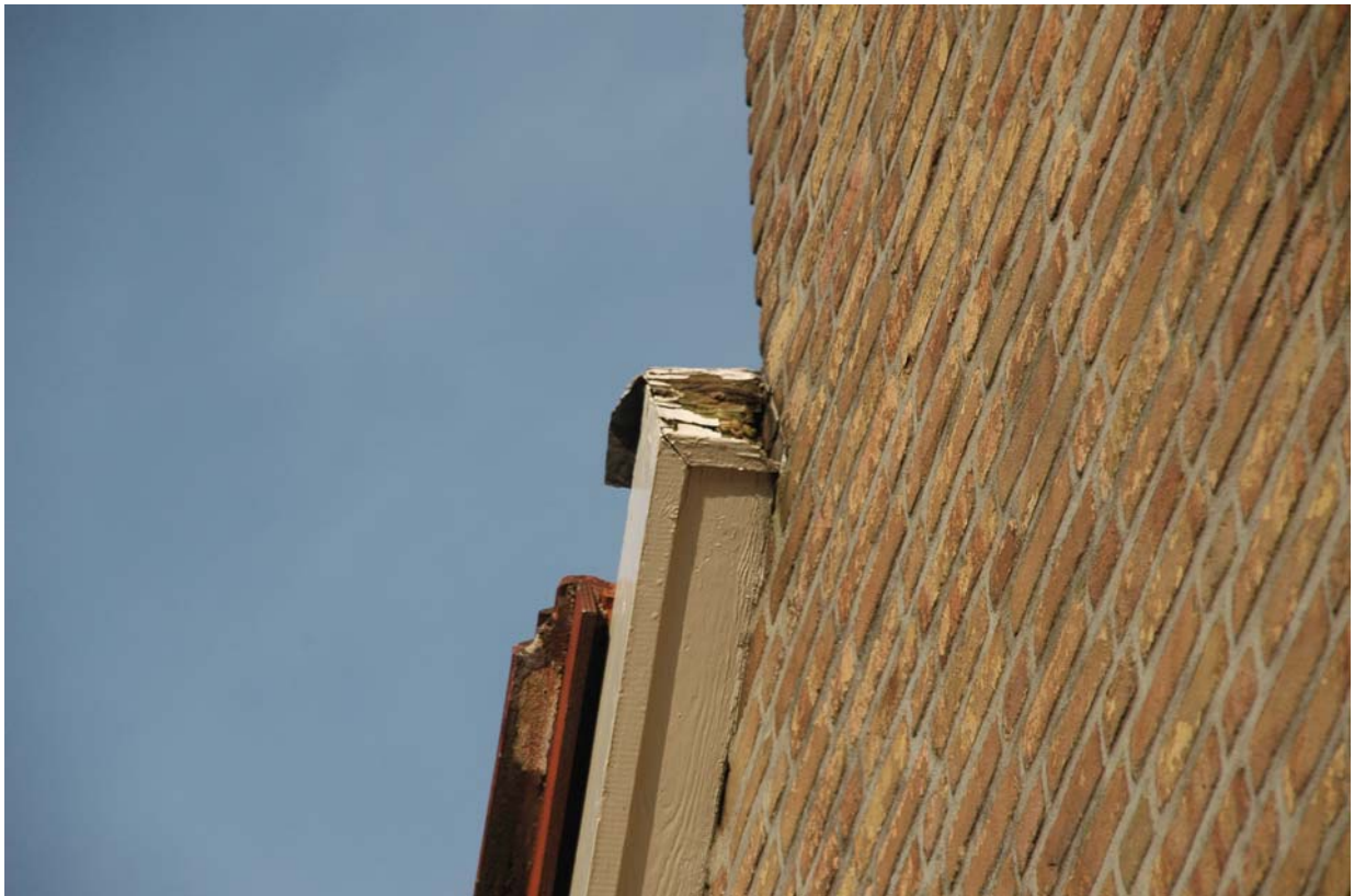
foto 7: Herstel houtaantasting combineren met herstel kantpannen.
