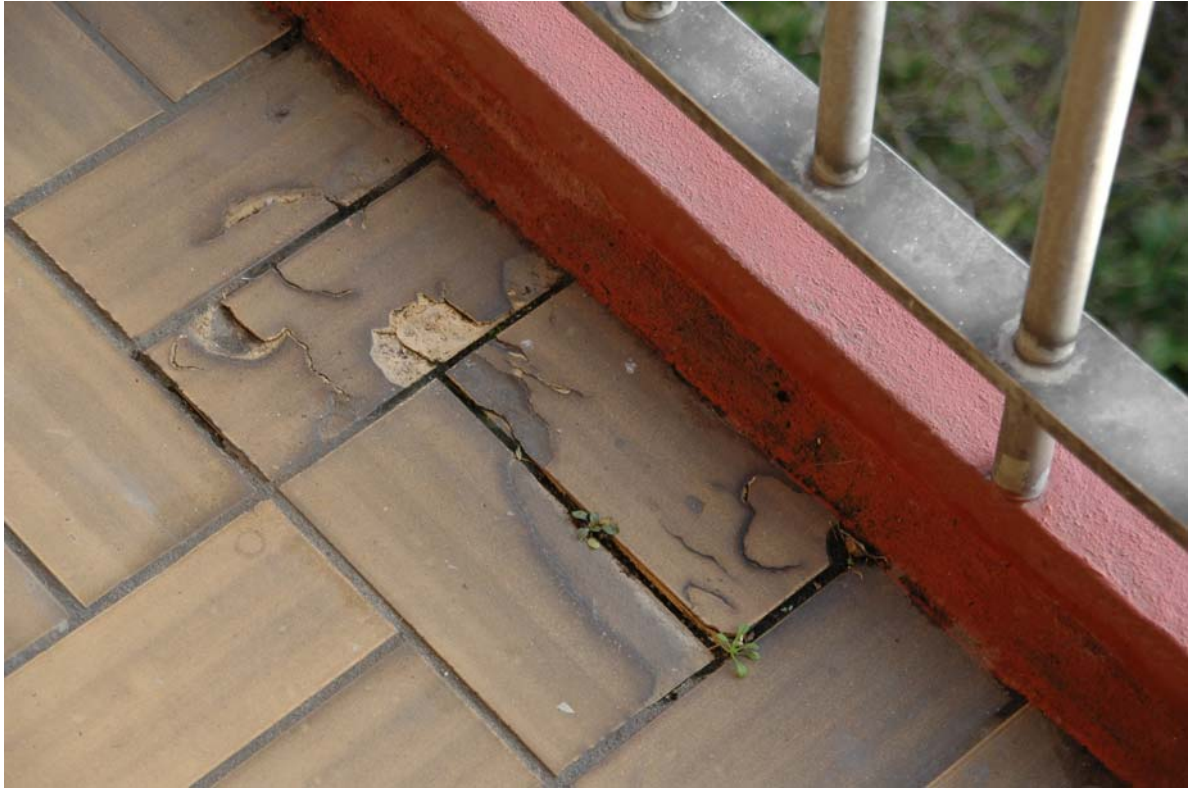
foto 5: Enkele tegels zijn kapot gevoren.
