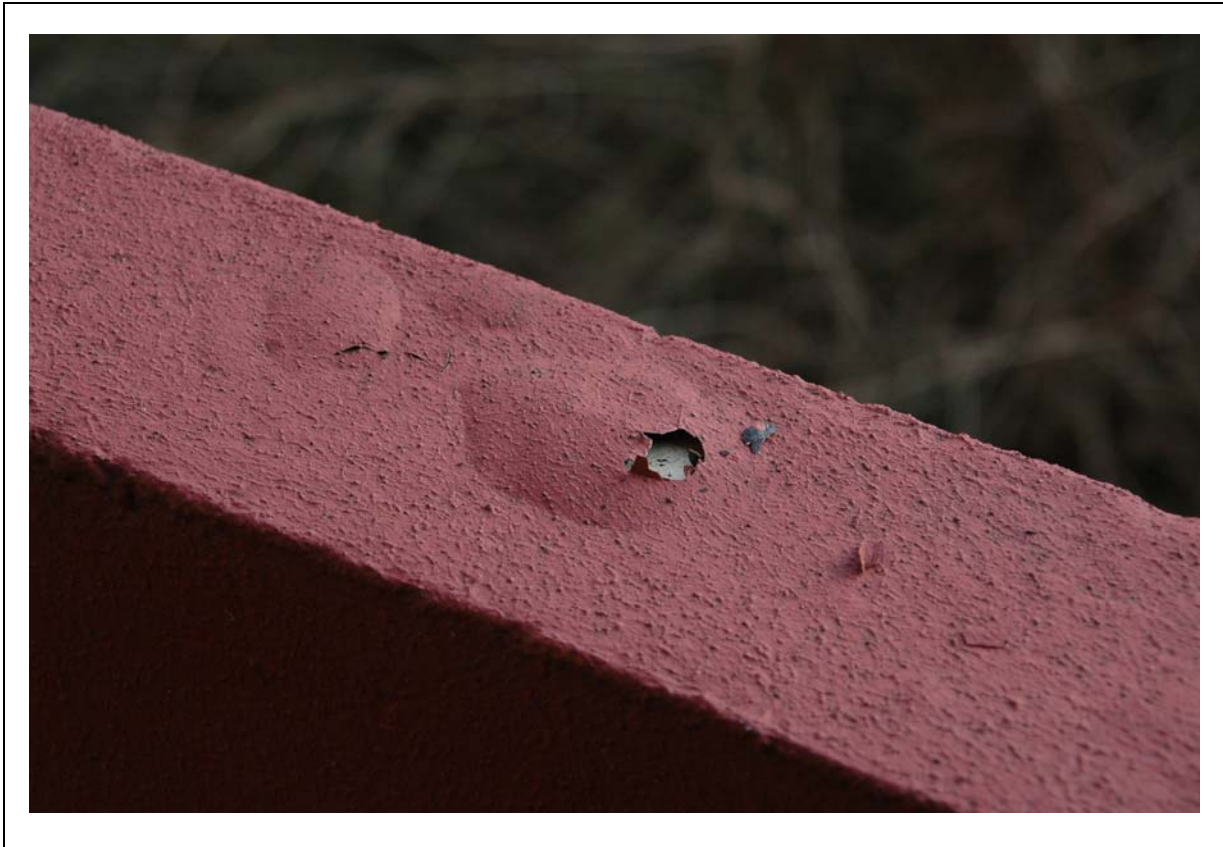
foto 11: Blaasvorming van de coating aan de achterzijde.
